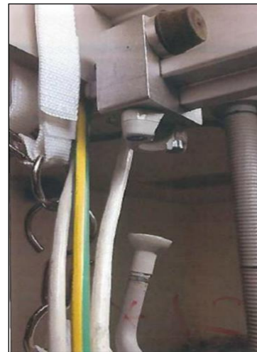
Slomljeno plastično kućište ležaja. To će dovesti do pada crijeva kabela.
